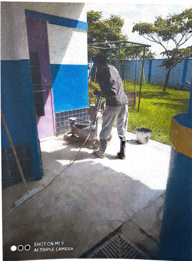
Reestruturação do piso sala de corpo movimento e sala 05 (caimento do piso, período de chuva água inundava as salas. Empresa contratada - CDM - 09/01/2020.
